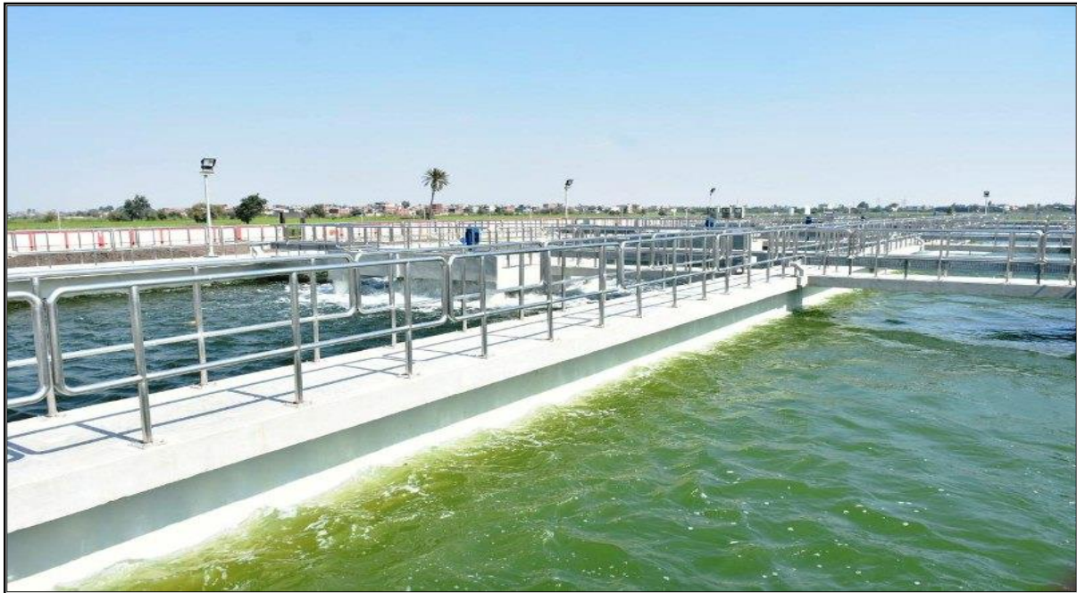
محطة مياه أبو كبير
